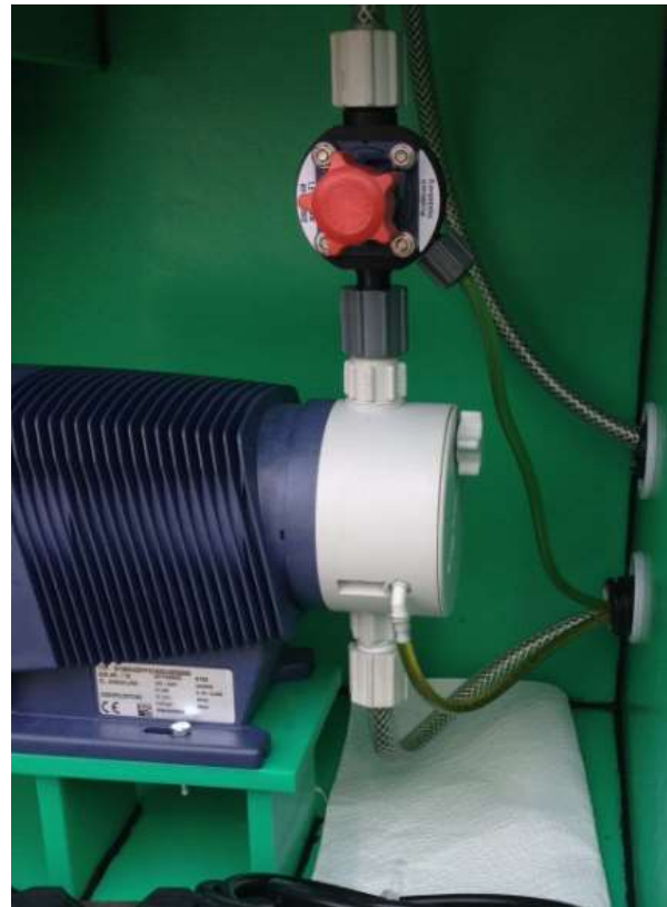
Dosierpumpe mit Rückführschläuchen
